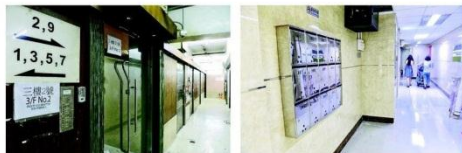
成連4處違章 許綺芹透過康翠材料貿易有限公司持有觀龍成連工業大廈3樓、4樓、5樓及6樓，包括在走廊上安裝鐵閘等，釘契自2008年發出至今未解除。
