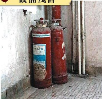
■現時並非所有唐樓都有消防設備，即使有亦十分殘舊。(顏晉傑攝)
