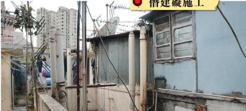
■舊樓天台的僭建物為消防安全工程的施工帶來困難。(顏晉傑攝)
