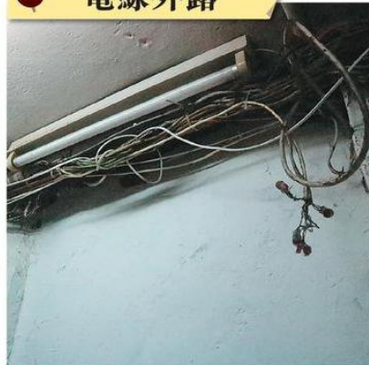
■部分唐樓的梯間現時吊有電線。(顏晉傑攝)
