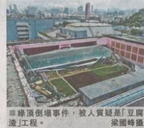
綠頂倒塌事件，被人質疑是「豆腐渣」工程。梁國峰攝
