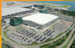
Building Construction 樓宇建築 Hong Kong International Airport SkyPlaza 香港國際機場擴建天廊
